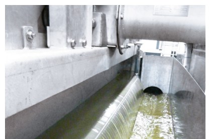
Ablauf des gesiebten Abwassers
